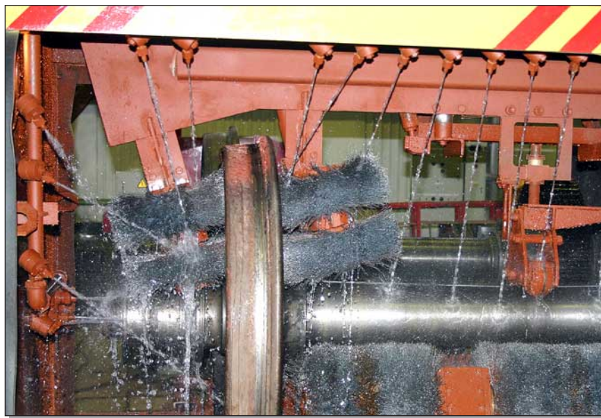
Рис. 8. Настройка форсунок при отключенном насосе высокого давления
